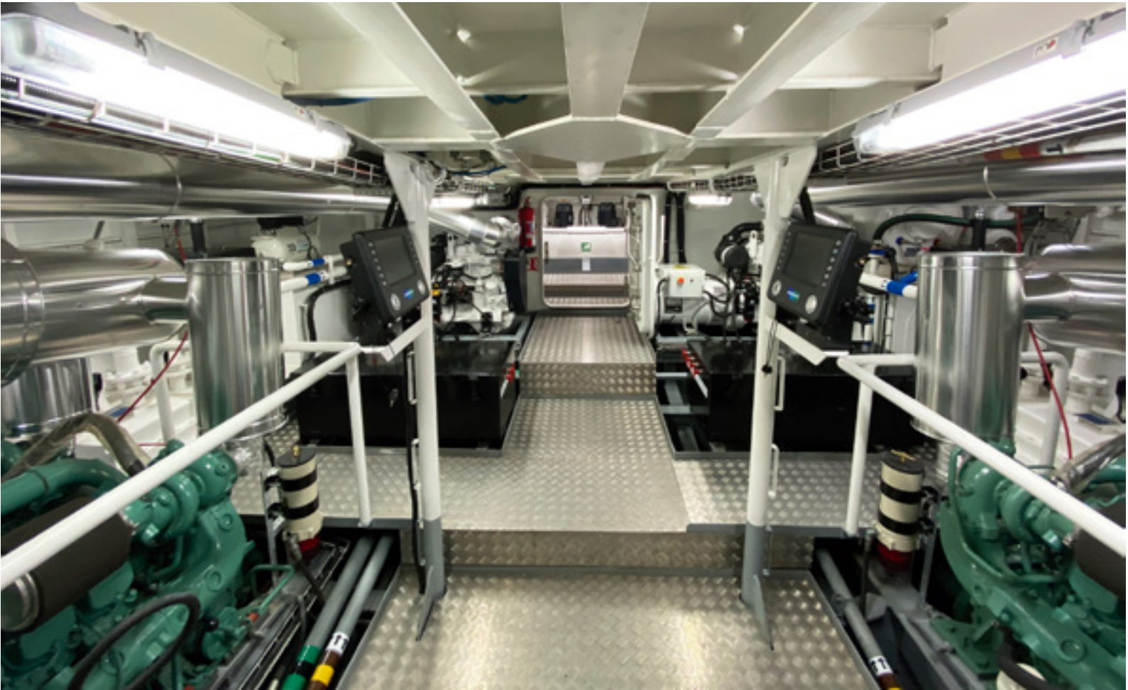
Sala de máquinas
